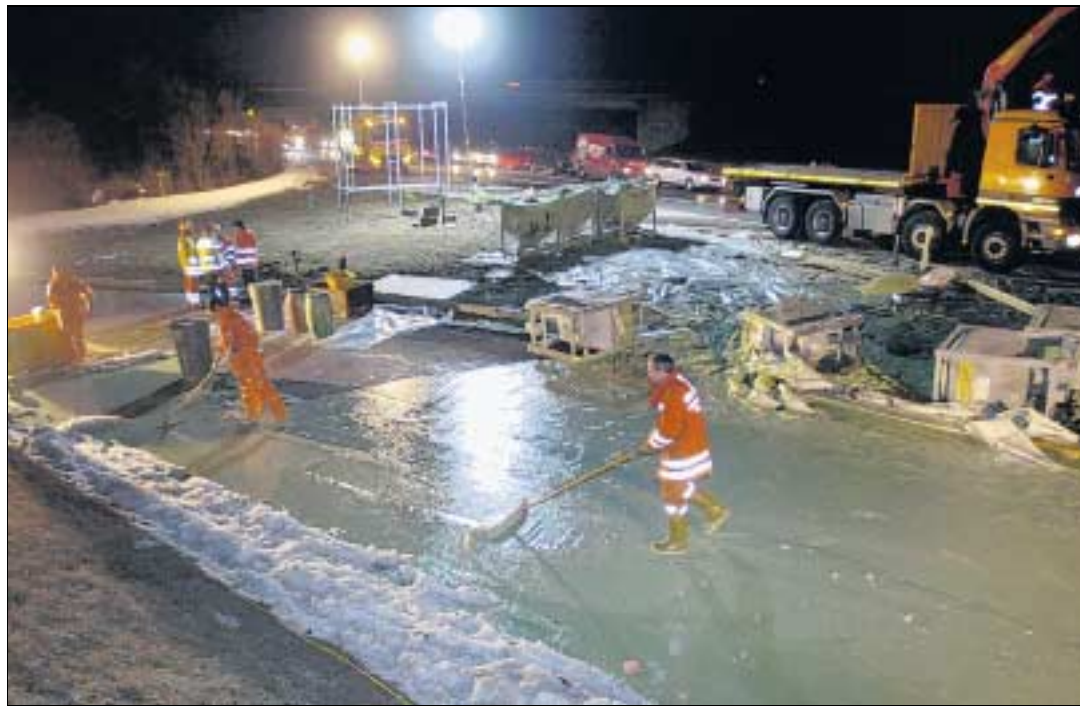
Nach dem Unfall war die A 1 bei Lindau noch für längere Zeit wegen Aufräumarbeiten gesperrt.
